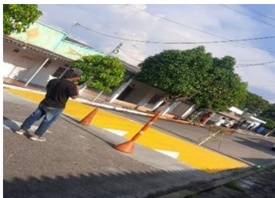
Reductor Barrio Simón Bolívar - Transversal 35 Diagonal 44B Y 45
