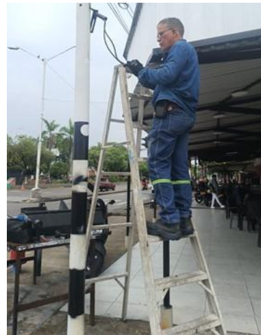
Mantenimiento intersecciones semafóricas
