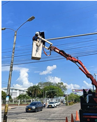
Mantenimiento intersecciones semafóricas
